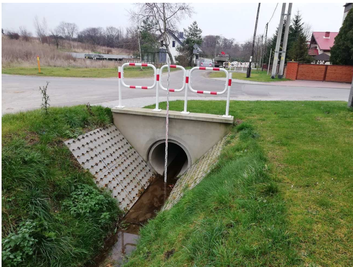
Rysunek 3. Istniejący przepust Ø1000 mm pod skrzyżowaniem ul. Dolnej i ul. Chorwackiej.
