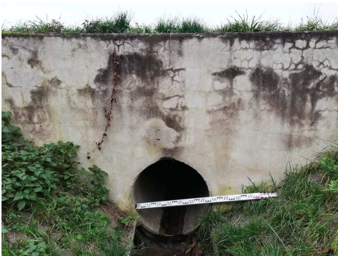
Rysunek 4. Istniejący przepust \varnothing 700 mm na przedłużeniu ul. Dolnej stanowiący dojazd do pól.
